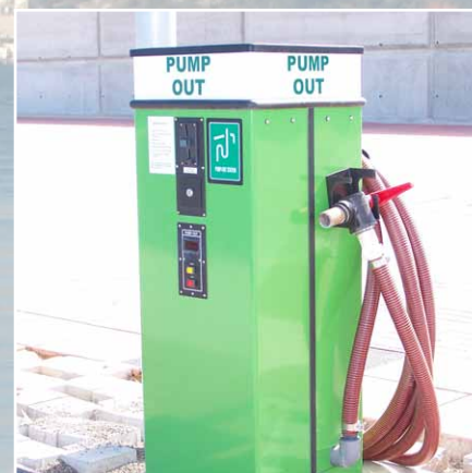
Torretas de Recogida de Aguas Residuales
