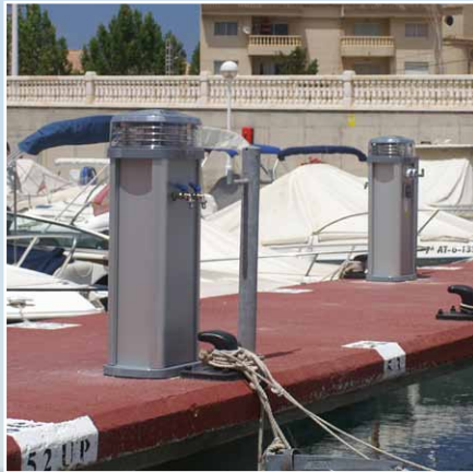
Torretas de Electricidad y Agua
