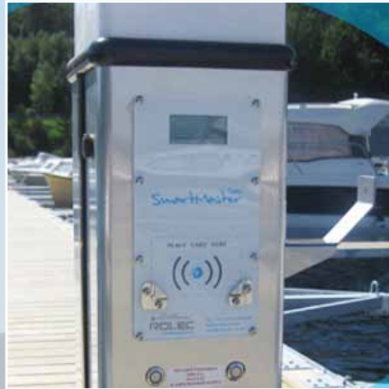
Torretas con Sistema Prepago
